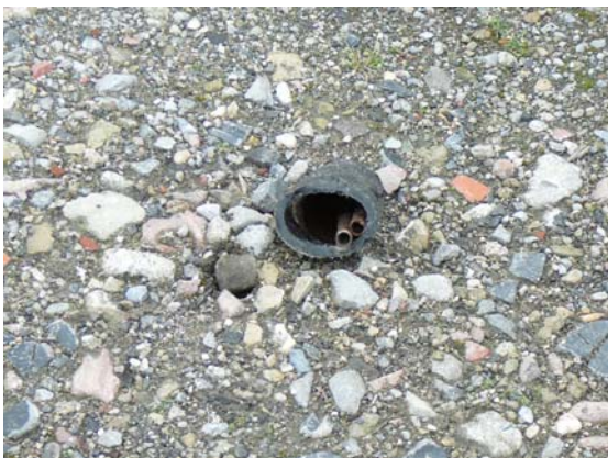
Bild 02: Ansicht abgetrennte unterirdische Heizölleitung (Blickrichtung E, Datum 22.06.11)
