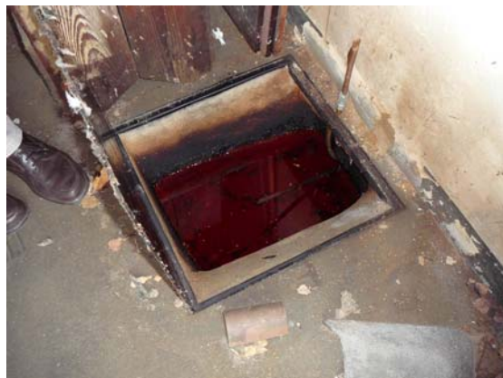
Bild 03: Ansicht der mit Heizöl gefüllten Vertiefung im Heizungsraum der ehem. Schreinerei (Blickrichtung SSW, Datum 22.06.11)
