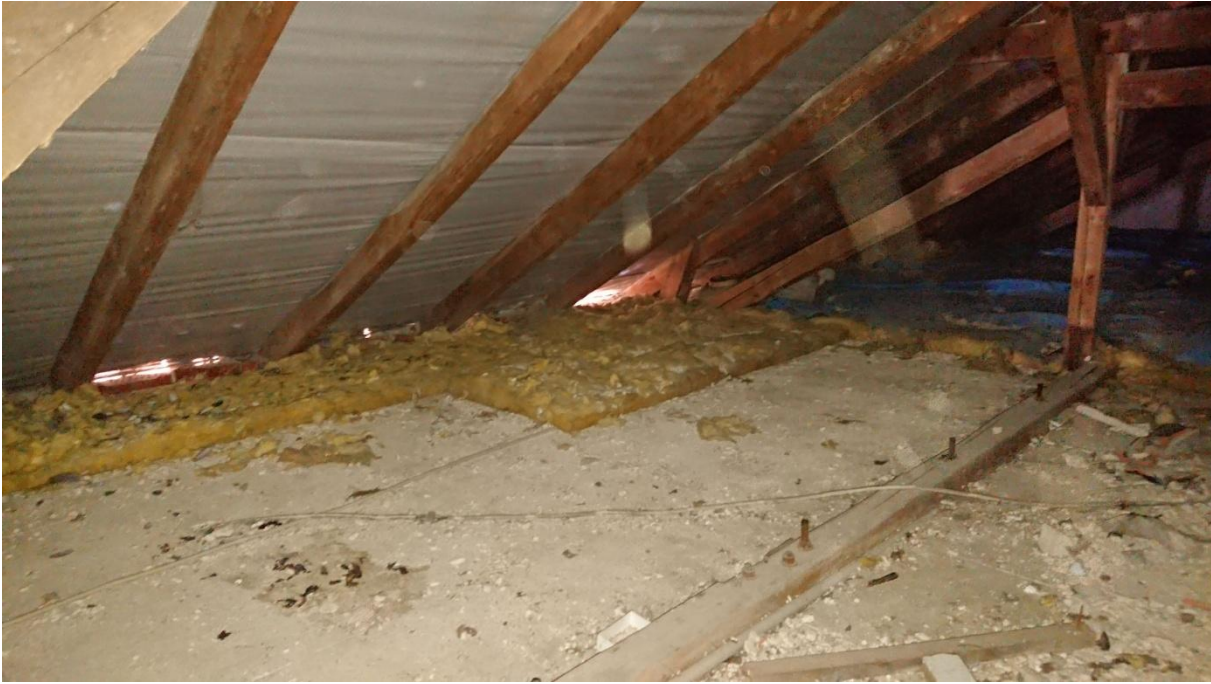
Foto 9: Dachboden mit Marderkot
